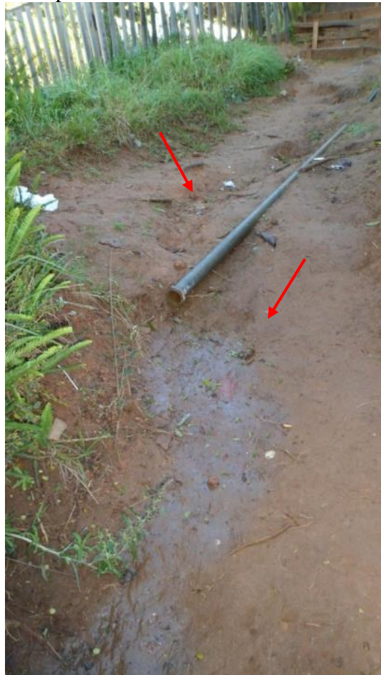
Figura 3 – Exemplo de encanamento a céu aberto e solo saturado
