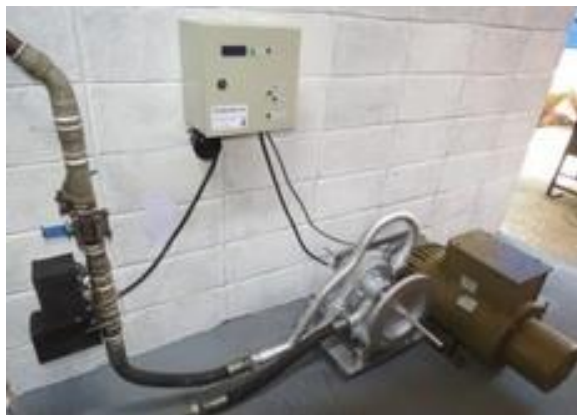
Figura 3: turbina e gerador.
