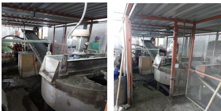
Figura 1- Vista do misturador e esteira de transporte.
