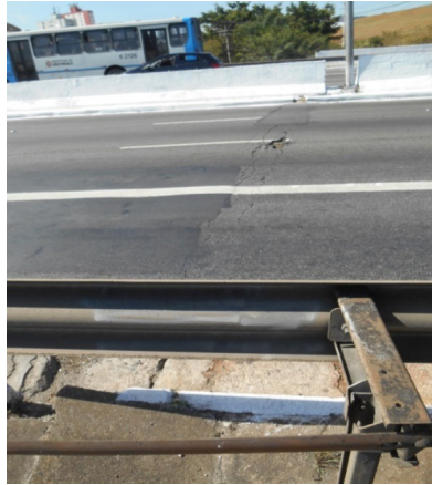
Figura 19 - Fissuras e remendos presentes na pista (Autor)
