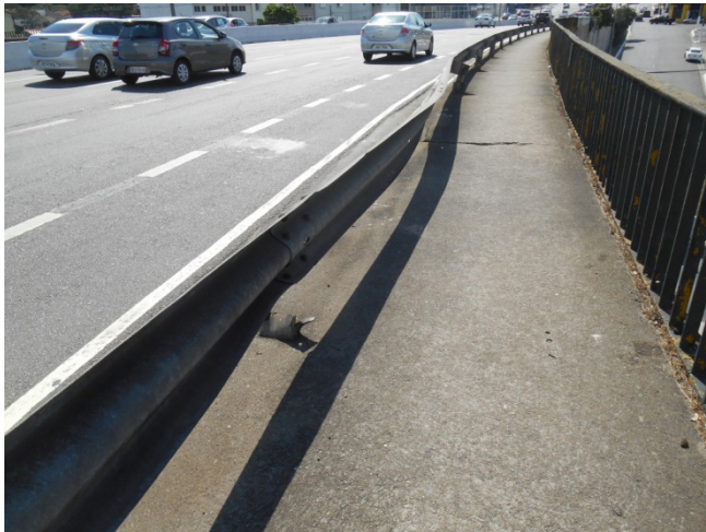
Figura 22 – Defesa metálica com desalinhamento (Autor)
