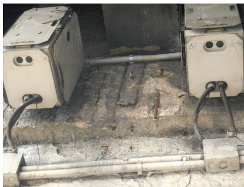
Figura 13 - Armadura exposta e oxidada (Autor)
