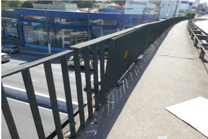
Figura 21 - Guarda-corpo danificado (Autor)
