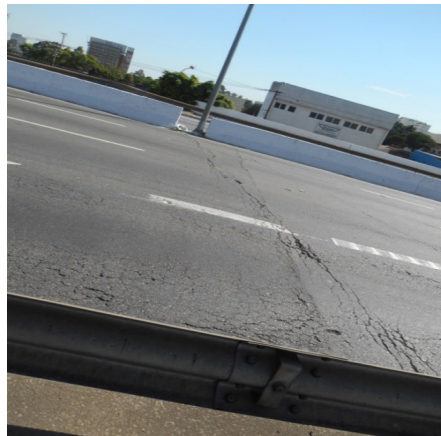
Figura 20 - defeito na junta de dilatação (Autor)
