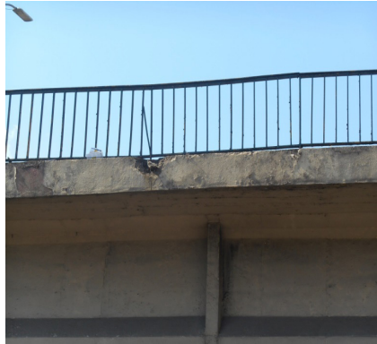
Figura 11 - Concreto disgregado na laje de passeio (Autor)
