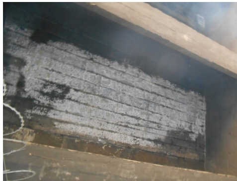
Figura 12 - Vigas com machas brancas
