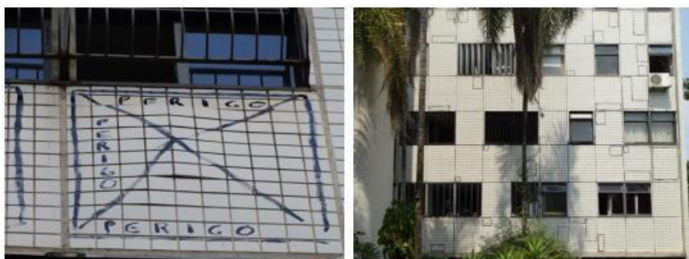
Figura 10: Identificação das áreas comprometidas
