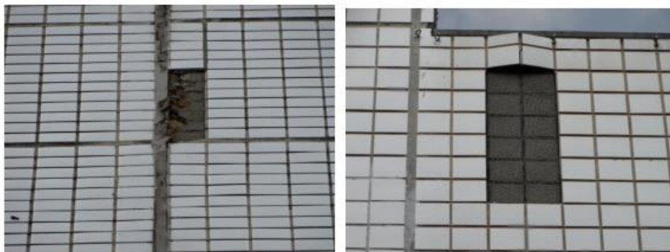
Figura 7: Deslocamento Encontrado no Edifício Analisado
