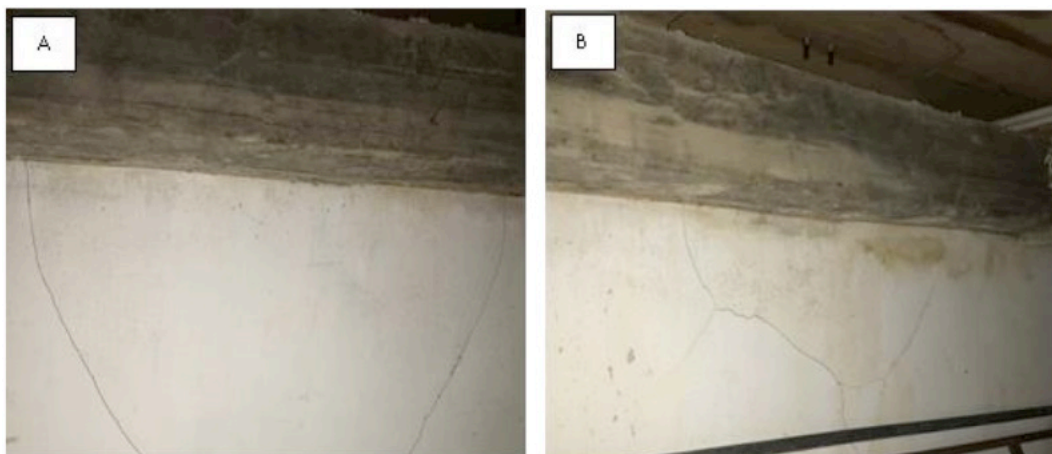
Figura 4 – (A) Fissuras em parede; e (B) Fissuras e manchas em parede.
