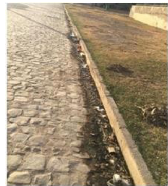
Figura 4 – Área com esgoto a céu aberto em rua calçada no bairro Sebastião Maltez
