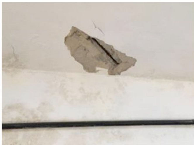
Figura 3 – Laje da sala de ensaios com armadura exposta e deslocamento de concreto.
