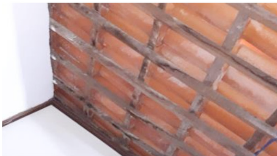
Figura 10 – Bolor nos caibros e terças do telhado.
