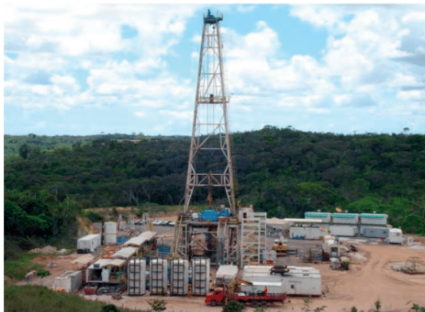
Figura 1. Sonda 108 da Petrobras em operação no Recôncavo Baiano (PIRES, 2009).
