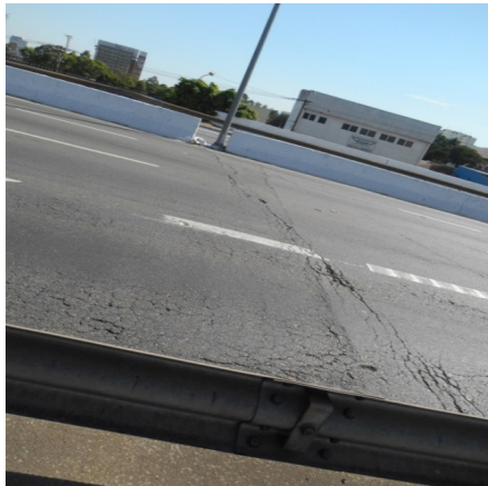
Figura 20 - defeito na junta de dilatação (Autor)
