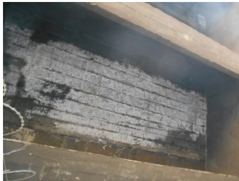
Figura 12 - Vigas com machas brancas
