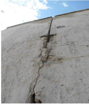
Figura 17 – Muro da ala com fissuras e armadura exposta (Autor)
