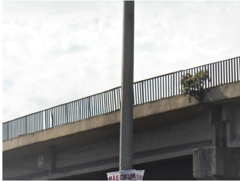
Figura 15 - Vegetação da área da junta de dilatação (Autor)
