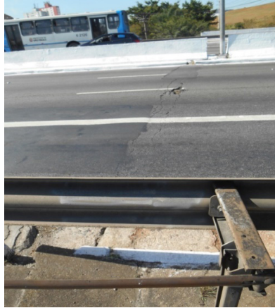
Figura 19 - Fissuras e remendos presentes na pista (Autor)
