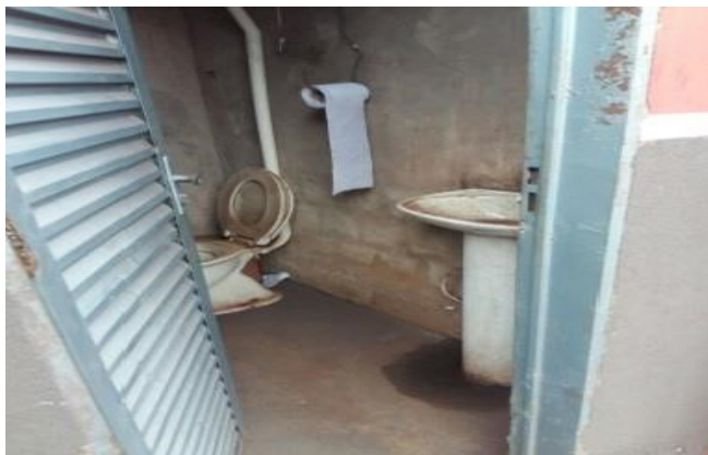
Figura 6 – Banheiro em péssimas condições sanitárias Fonte: Elaborado pelos autores (2019)
