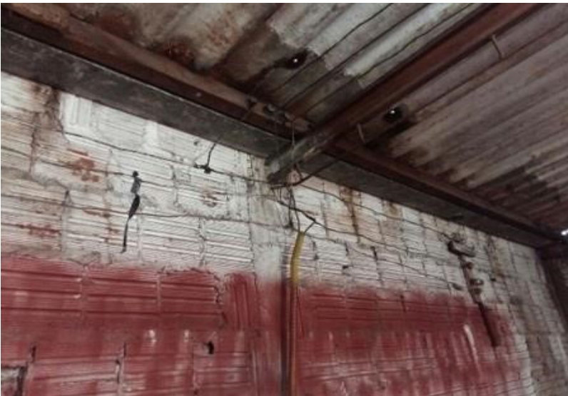
Figura 2 - Instalação Elétrica e Estrutura Comprometida
